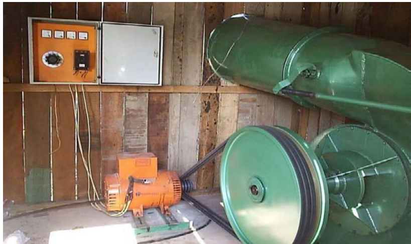
Cette turbine et ce générateur de micro-hydroélectricité a apporté du courant électrique et une grande satisfaction à une communauté rurale en zone reculée au Brésil. 2006.
